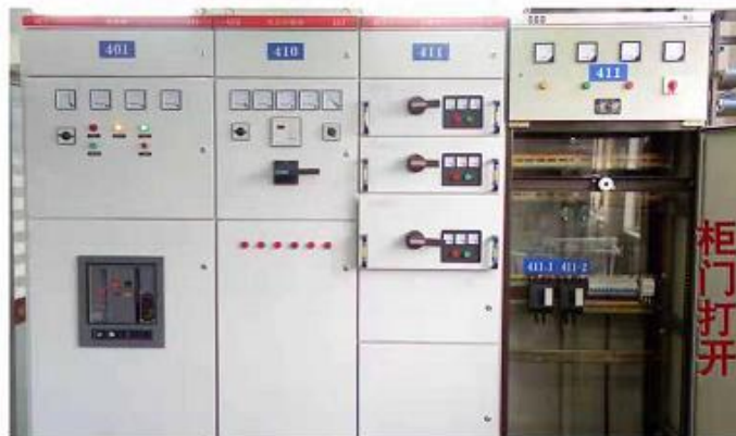
固定式出线柜中的411-1和411-2断路器
