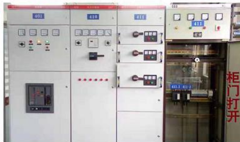
固定式出线柜中的411-1和411-2断路器
